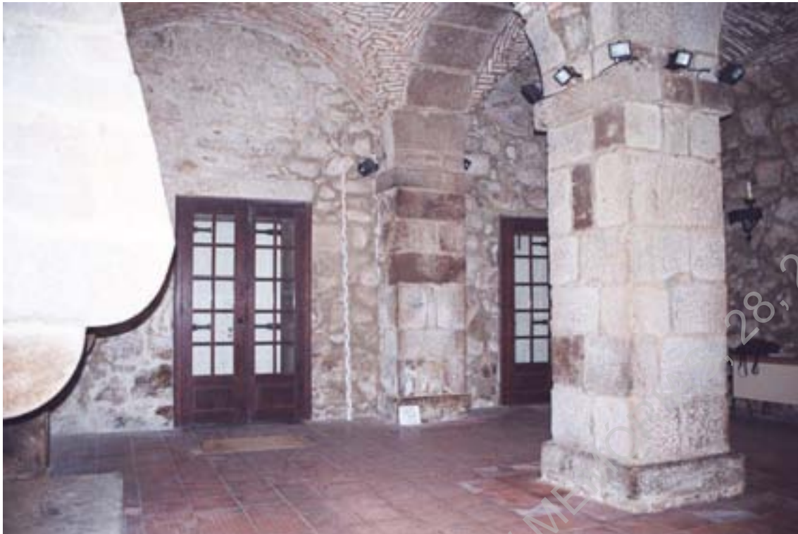
Foto 7 – Aspecto de divisão piso inferior da antiga cadeia de Praça-Forte de Valença.
